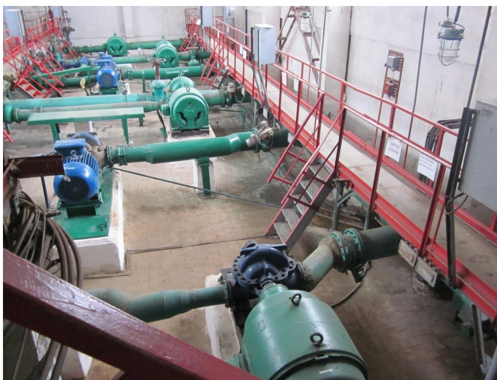
Общий вид машинного зала станции 2-го подъема.
